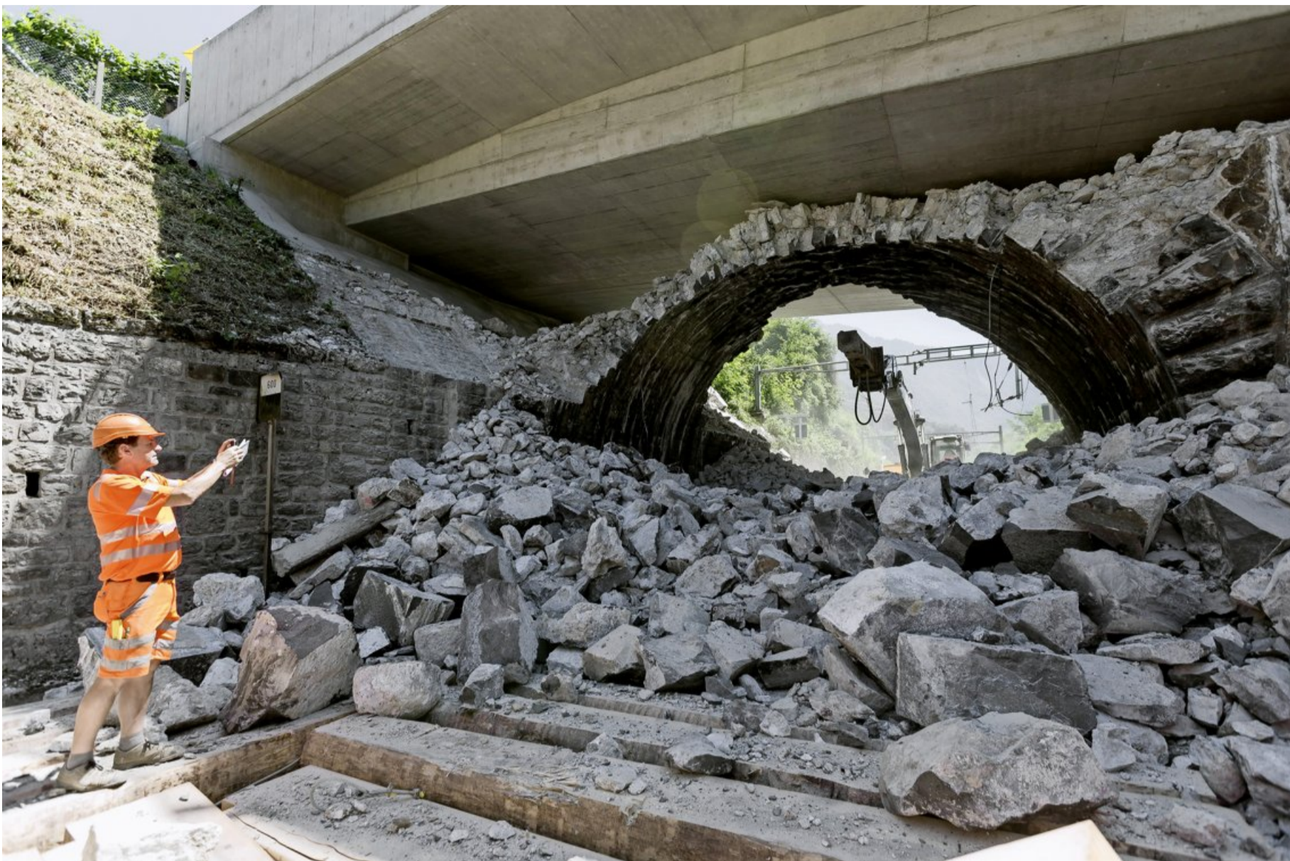
L'aqueduc de la Veraye a été construit entre 1860 et 1870. Deux monstrueux marteaux-piqueurs l'ont détruit en sept heures ce samedi. KEYSTONE/CYRIL ZINGARO
